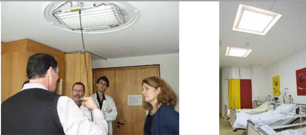
Links: Ortstermin, Patientenzimmer Klinikum rechts der Isar; rechts: Einbau der Leuchte im Klinikum Bamberg
